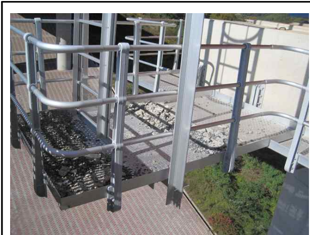
P5 점검로 폐콘크리트 퇴적(1.0m×1.0m)
